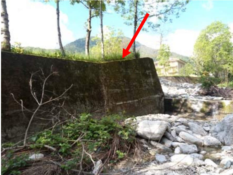
Figura 5.8.1: sponde in c.a. con rischio di caduta dall'alto da delimitare con recinzione di cantiere per impedire l'avvicinamento degli addetti.
